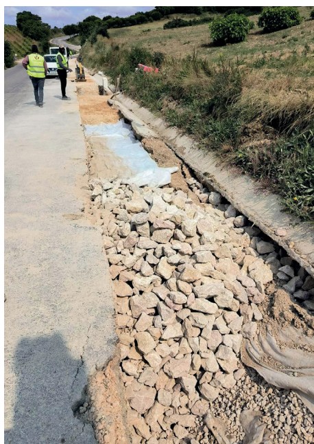
■ Vala de drenantes em A do Mourão
